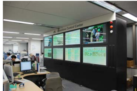
オペレーションコントロールセンター(OCC)
